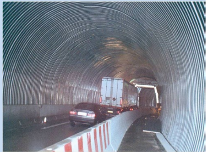
Más de 12,000 m 2 de malla de acero inoxidable protegen el tráfico del hormigón desconchado
